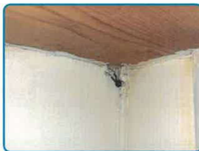
Anomalie B.7.3 d sur Install. n°1
