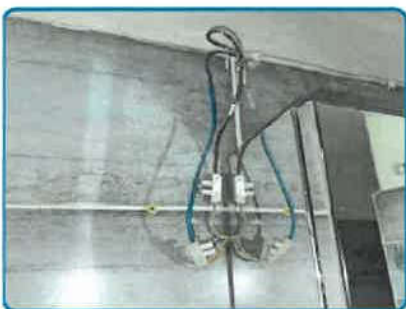
Anomalie B.7.3 d sur Install. n°1
