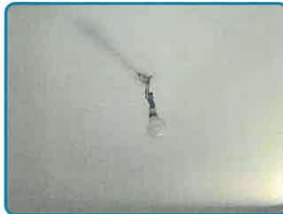
Anomalie B.8.3 b sur Install. n°1
