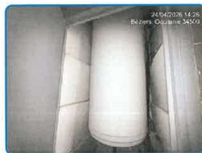
Equipement Eau Chaude Sanitaire (ECS)
