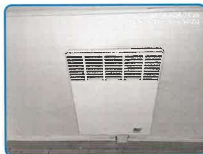
Equipement de chauffage électrique
