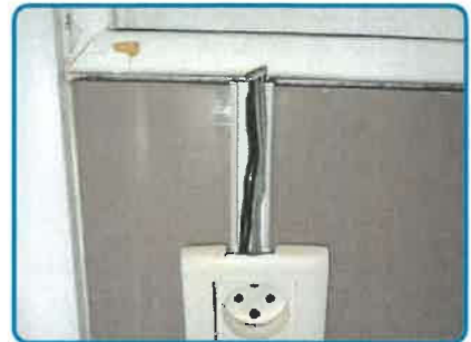
Anomalie B.8.3 e sur Install. n°1
