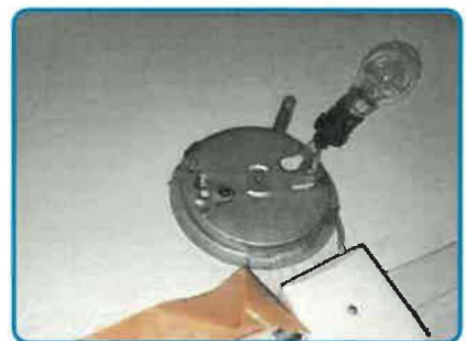
Anomalie B.7.3 a sur Install. n°1
