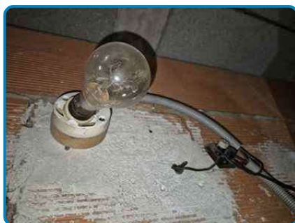
Anomalie B.7.3 a sur Install. n°1
