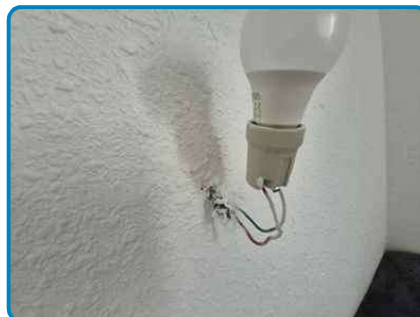
Anomalie B.8.3 e sur Install. n°1
