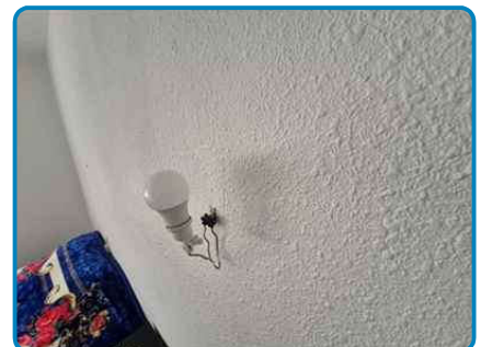
Anomalie B.7.3 d sur Install. n°1
